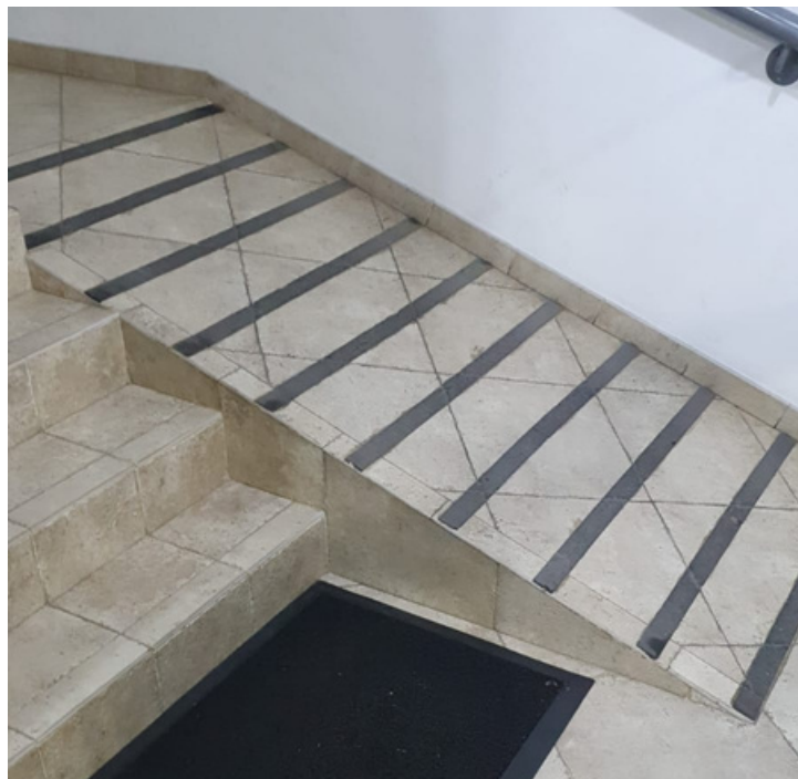
Rampa com grau de inclinação elevado.
